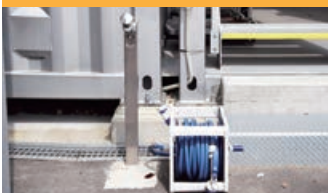
サービス水道設備
